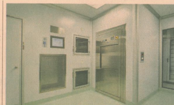
Una realizzazione Isolsistem
